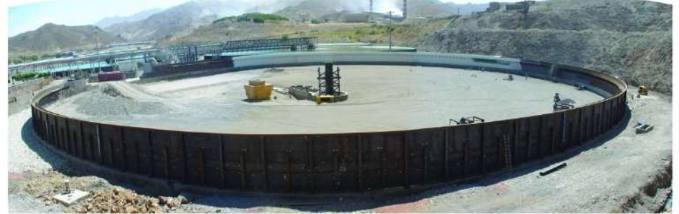
ساخت، نصب و راه اندازی مخزن تیکتر باطله - به قطر ۱۲۰ متر به همراه کلیه تجهیزات داخلی
