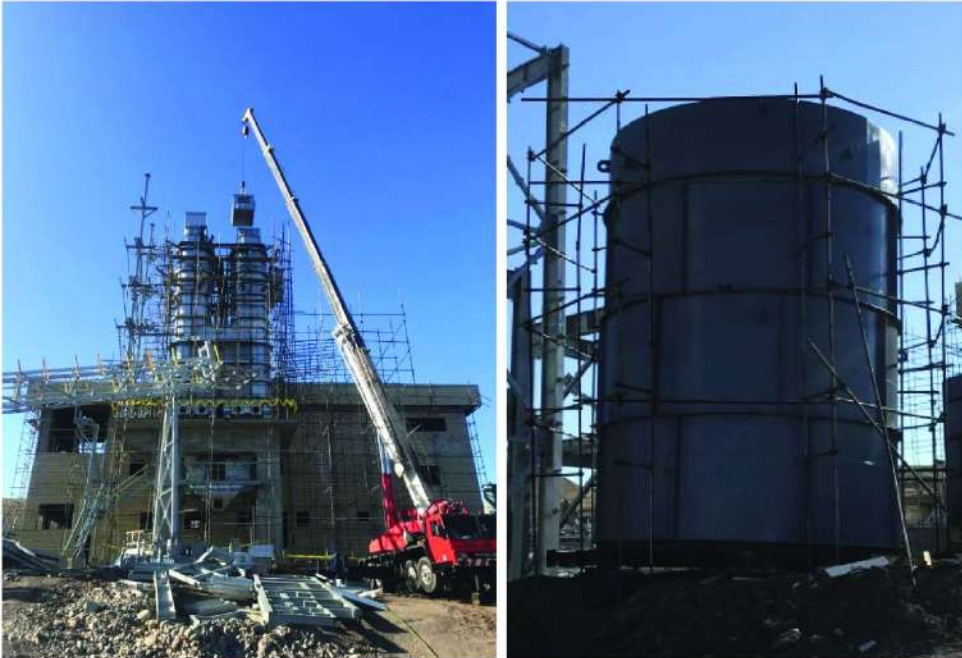
ساخت و نصب مخازن و سیلوهای پروژه آهک اهر (Diluent Tank Storage , Tank Gas Oil)
