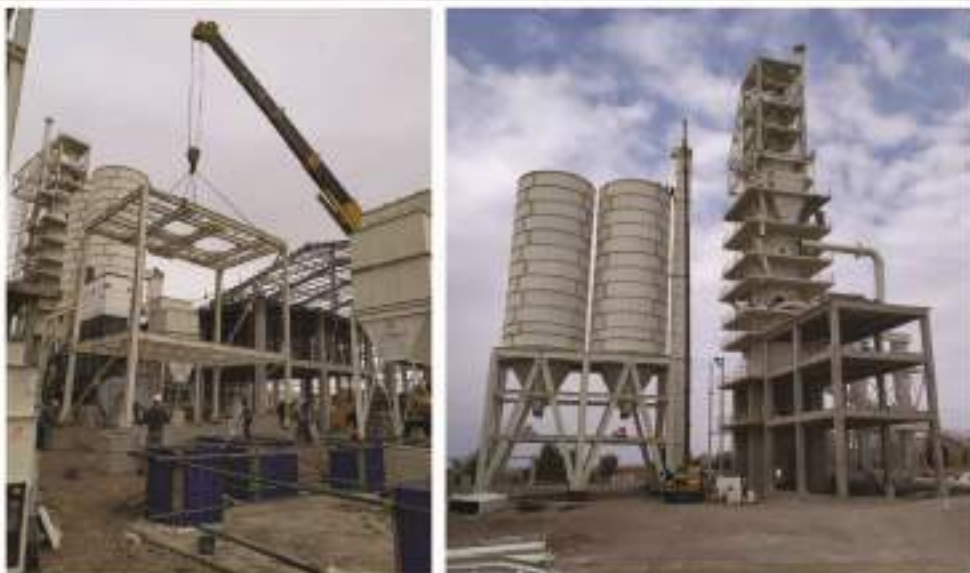
ساخت، نصب و راه اندازی تجهیزات پروژه کربنات کلسیم رسوبی سبز وار
