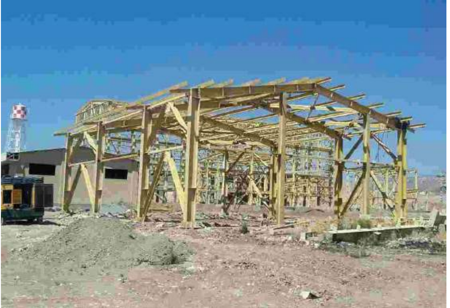
ساخت و نصب سازه های هیدرولیک نیروگاه سیکل ترکیبی دالاهو، پارکینگ داخلی و خارجی
